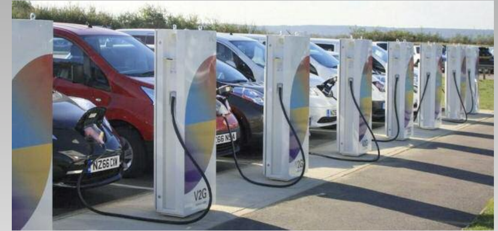
Stazioni di ricarica auto elettriche Electric cars charging stations
